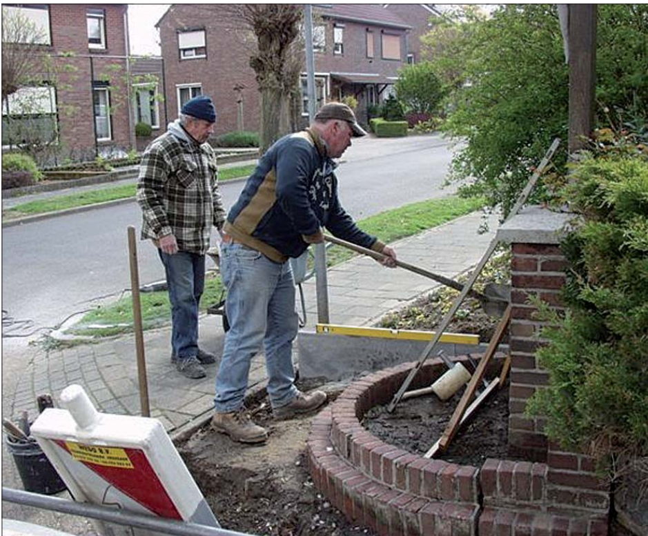
Vrijwilligers bezig het herstelwerkzaamheden aan het buurtkruis bij de aansluiting Burg. Eussenlaan/Schoolstraat te Spaubeek
